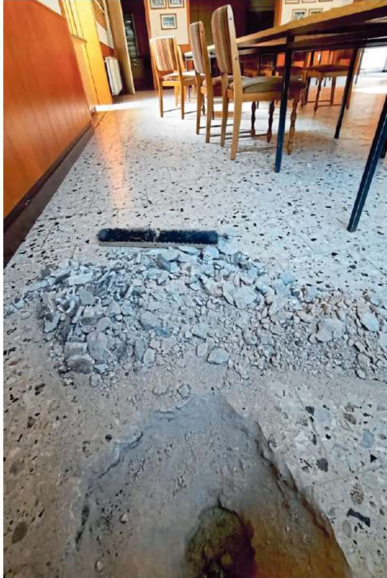
Vieles wird sich verändern: Das Dorfgemeinschaftshaus in Großenbreden wird schon bald umfassend saniert. Erste Bodenproben sind bereits entnommen.
